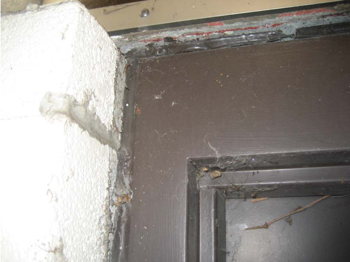
HA #6 – Non asbestos containing Dark Brown Caulk
